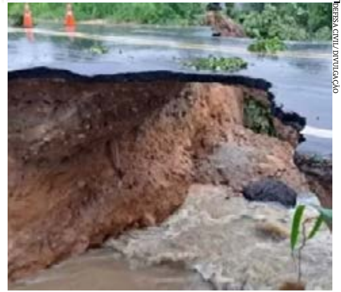
MG-105, entre Águas Formosas e Crisólita, totalmente interditada
