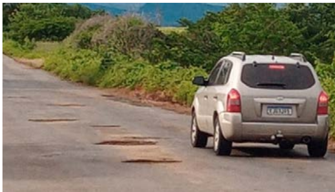
Provias busca reverter situação em que se encontram muitas rodovias mineiras, por falta de ação de governos anteriores
