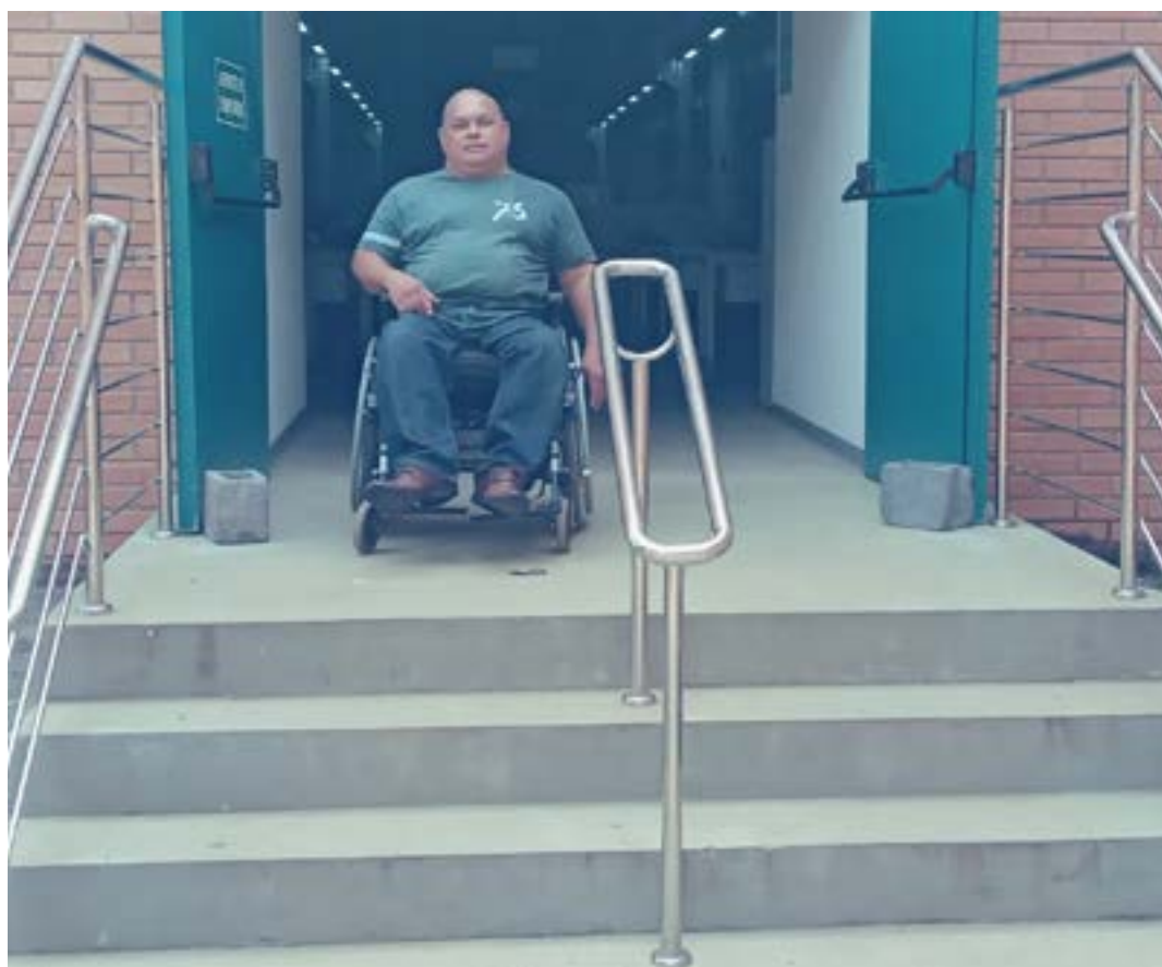
A falta de rampa é um dos motivos da reclamação
